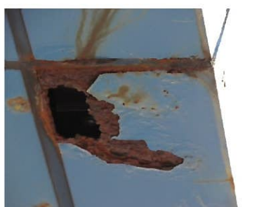
[化粧板の著しい腐食（拡大）]
