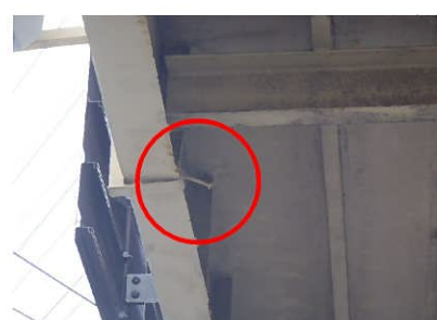
[ボルトのゆるみ（脱落寸前）]
