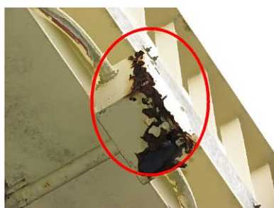
[プルボックスの著しい腐食]
