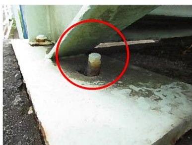
[固定ボルトの著しい腐食と損失]
