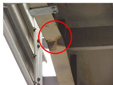
[主桁の変形（座屈）と腐食]
