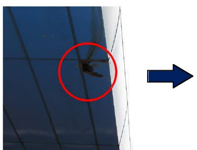
[化粧板の著しい腐食]
